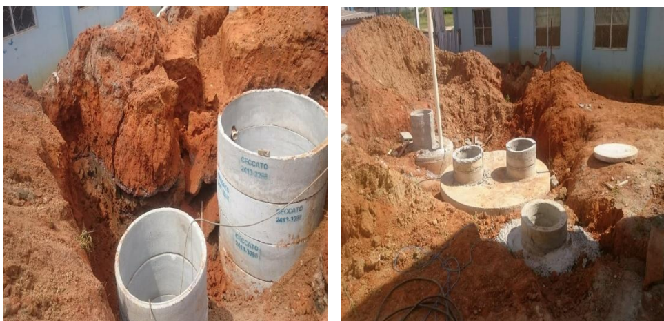
Figura 01. Filtros e Biodigestores.
