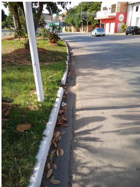
Figura 6 - Foto canaleta de drenagem na Av. Zoello Sola retiradas no dia 18/06/2020. Fonte: Lucas Marquesin e Iago Medeiros.
