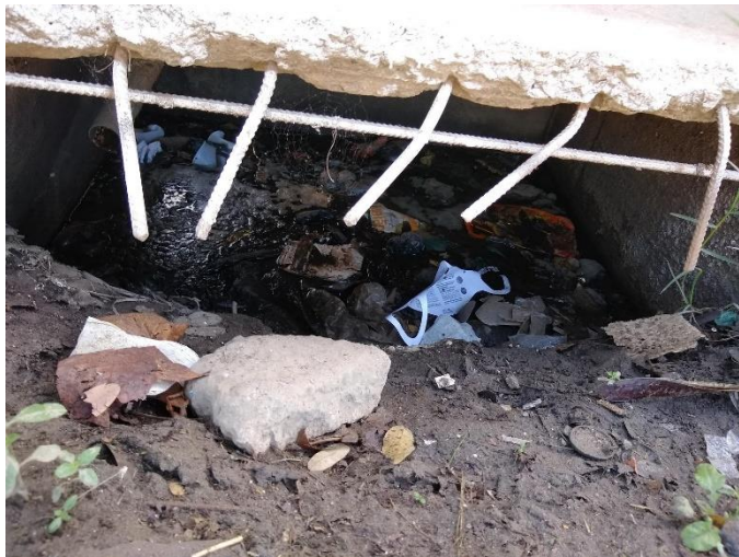
Figura 5 - Foto Bueiro na Av. Zoello Sola retiradas no dia 18/06/2020. Fonte: Lucas Marquesin e Iago Medeiros.
