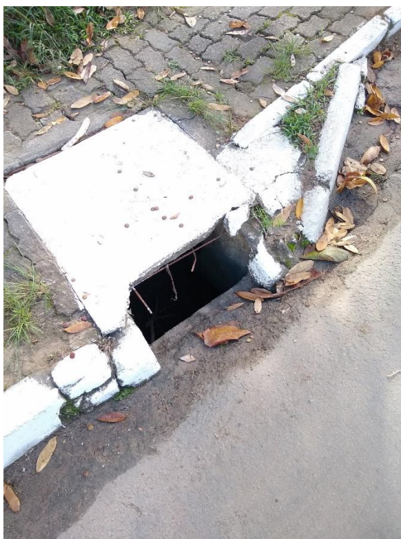
Figura 7 - Foto bueiro na Av. Zoello Sola retiradas no dia 18/06/2020. Fonte: Lucas Marquesin e Iago Medeiros
