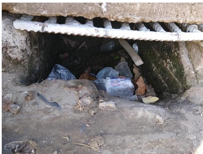
Figura 4 - Foto Bueiro na Av. Zoello Sola retiradas no dia 18/06/2020. Fonte: Lucas Marquesin e Iago Medeiros.
