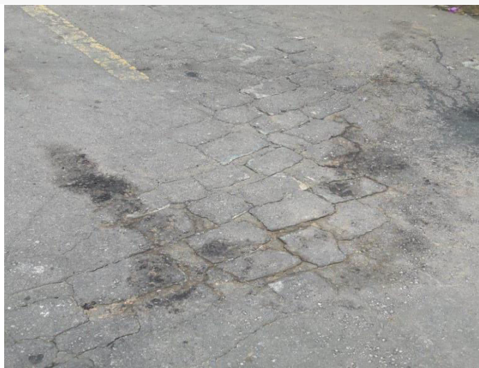
Figura 5 – Trinca tipo couro de jacaré, localizada na avenida Bento Gonçalves Pereira, Paraíba do Sul
