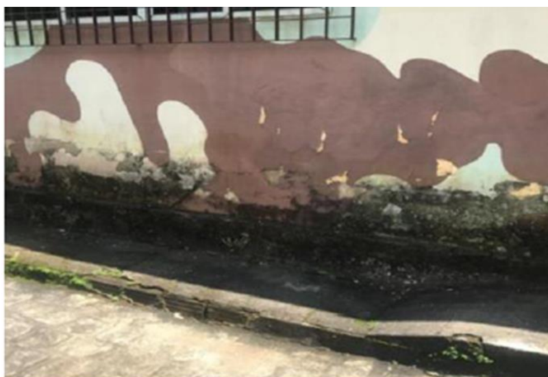
Figura 2. Infiltração na área externa da sede A.
