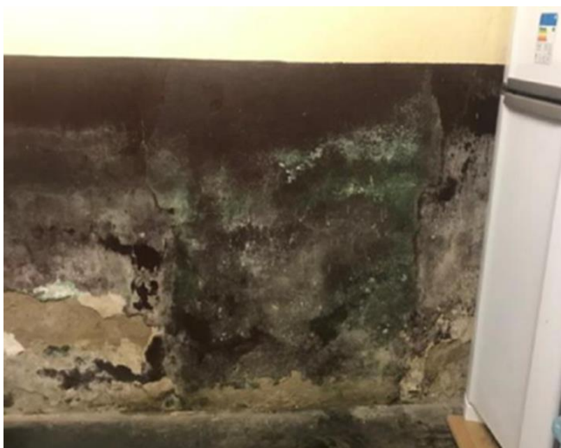
Figura 1. Infiltração por capilaridade na área interna sede A.
