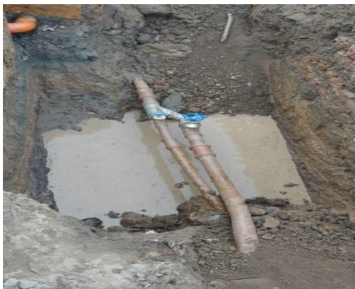
Figura 5: Vazamento na rede reparado
