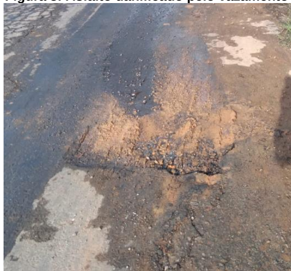
Figura 3: Asfalto danificado pelo vazamento
