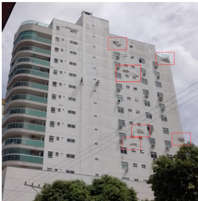
Figura 5: Descamação da camada de pintura.
