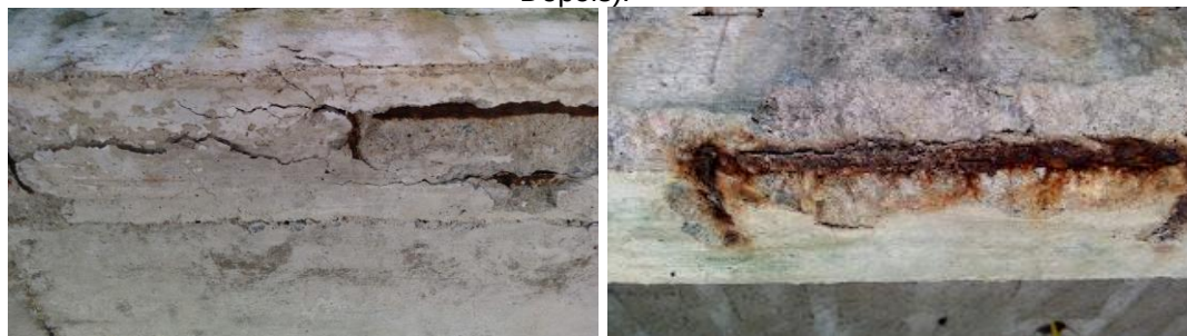
Figura 1: Deterioração por corrosão dos vergalhões causada pela delaminação do concreto (Antes X Depois).
